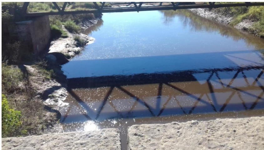
Márgenes aguas abajo
